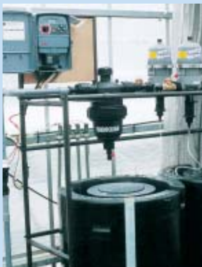
↑ 液肥混合システムユニット
