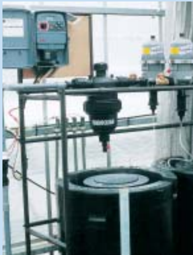
↑液肥混合システムユニット
