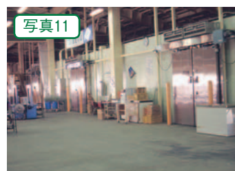
↑ 遠隔地輸送用の大型予冷施設（北海道）。
